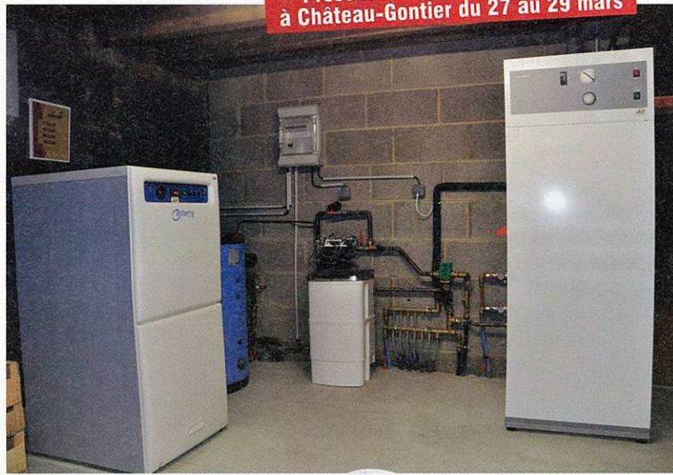
Installation d'une pompe à chaleur géothermique et d'un chauffe-eau thermodynamique. Association idéale pour de la basse consommation.
